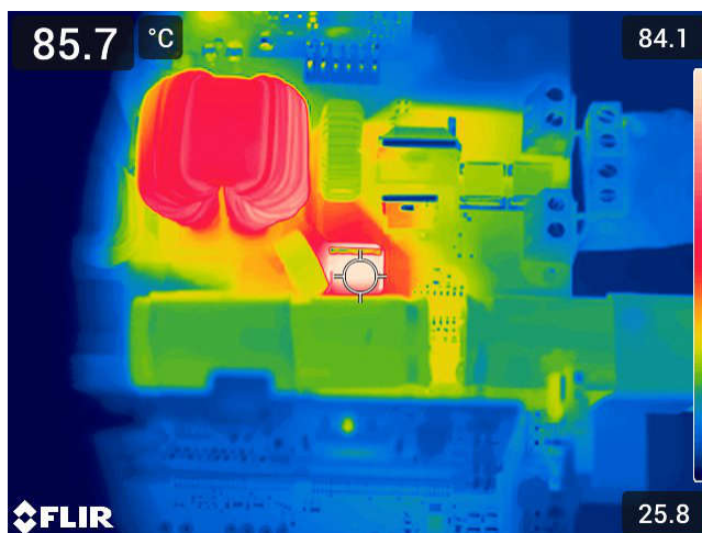
图 4-31. 继电器旁路开关热像图
